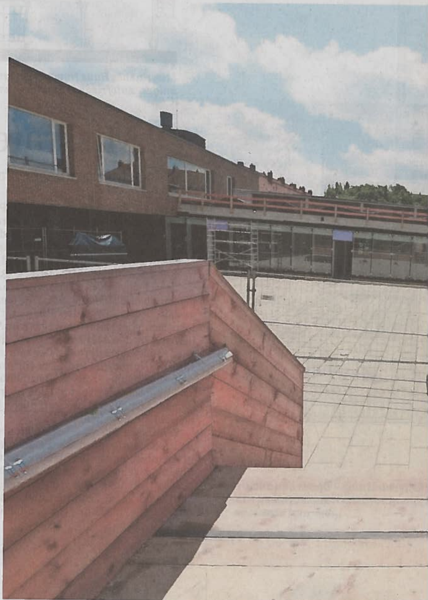
Ständig im Baustellen-Modus: Die private evangelische Lukas-Schule an der Riegerhofstraße, die man sich mit dem Sportverein teilt.
